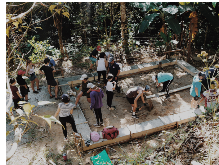
19. Retirando encofrado y moviendo material del Santuario de semillas. Nota. Como parte de la jornada de voluntariado con estudiantes del United World College. De Jimena Araya, 2023, Archivo Diwö. ©
