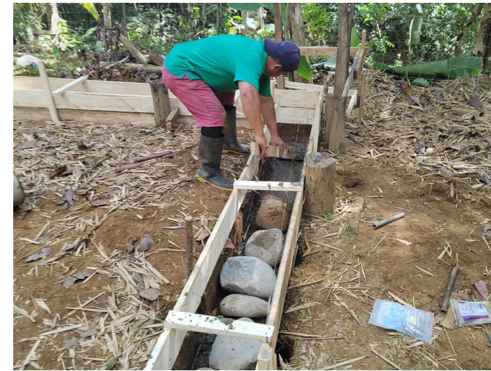
22. Construcción del zócalo de concreto ciclópeo del Santuario de semilla. Nota. En la foto Gerardo Maroto, maestro constructor de Boruca. De Lourdes Frasser, 2023, Archivo AAF. CC BY-NC 4.0
