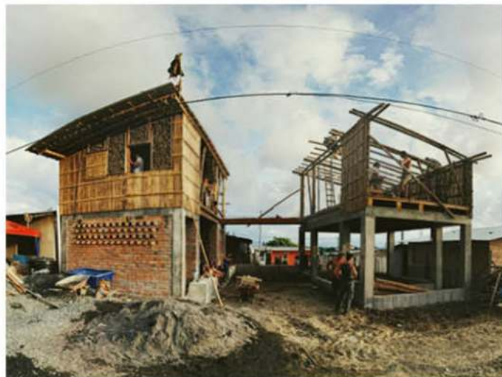
Figura 23 - Construcción colectiva de la segunda fase. La planta baja de la barra izquierda fue construida en la primera fase. © Studio Chamanga, MUAS
