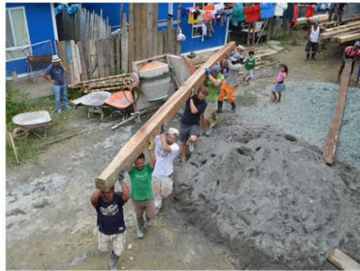
Figura 22 - Estudiantes de PSU y miembros de OM moviendo las vigas principales, aserradas por una organización campesina aliada. © Atarraya Taller
