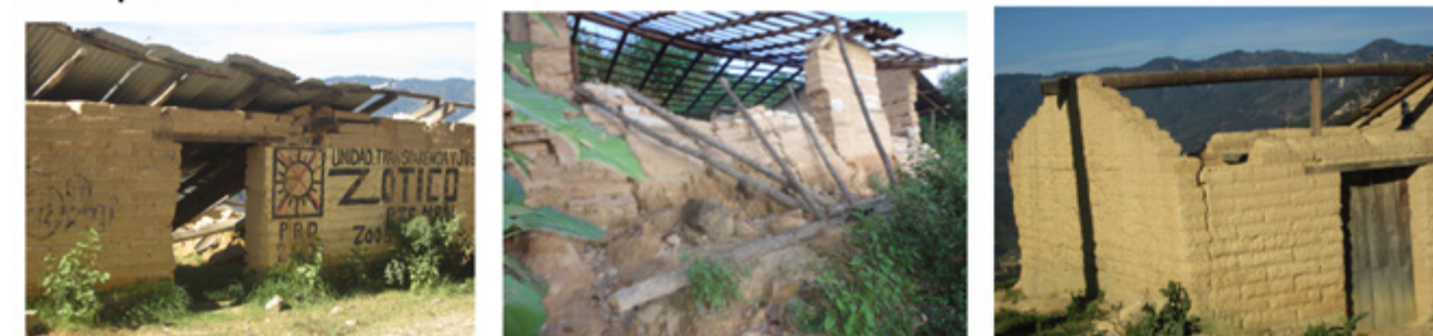
2. Daños. Créditos: Isadora Hastings, Jesús Álvarez.
