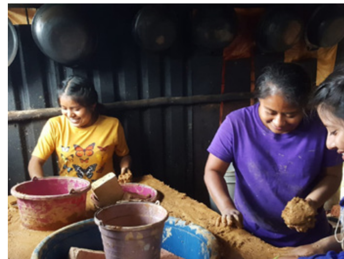
8. Construcción de estufas ahorradoras de leña (Ciénega 2021). Créditos: Isadora Hastings, Jesús Álvarez.
